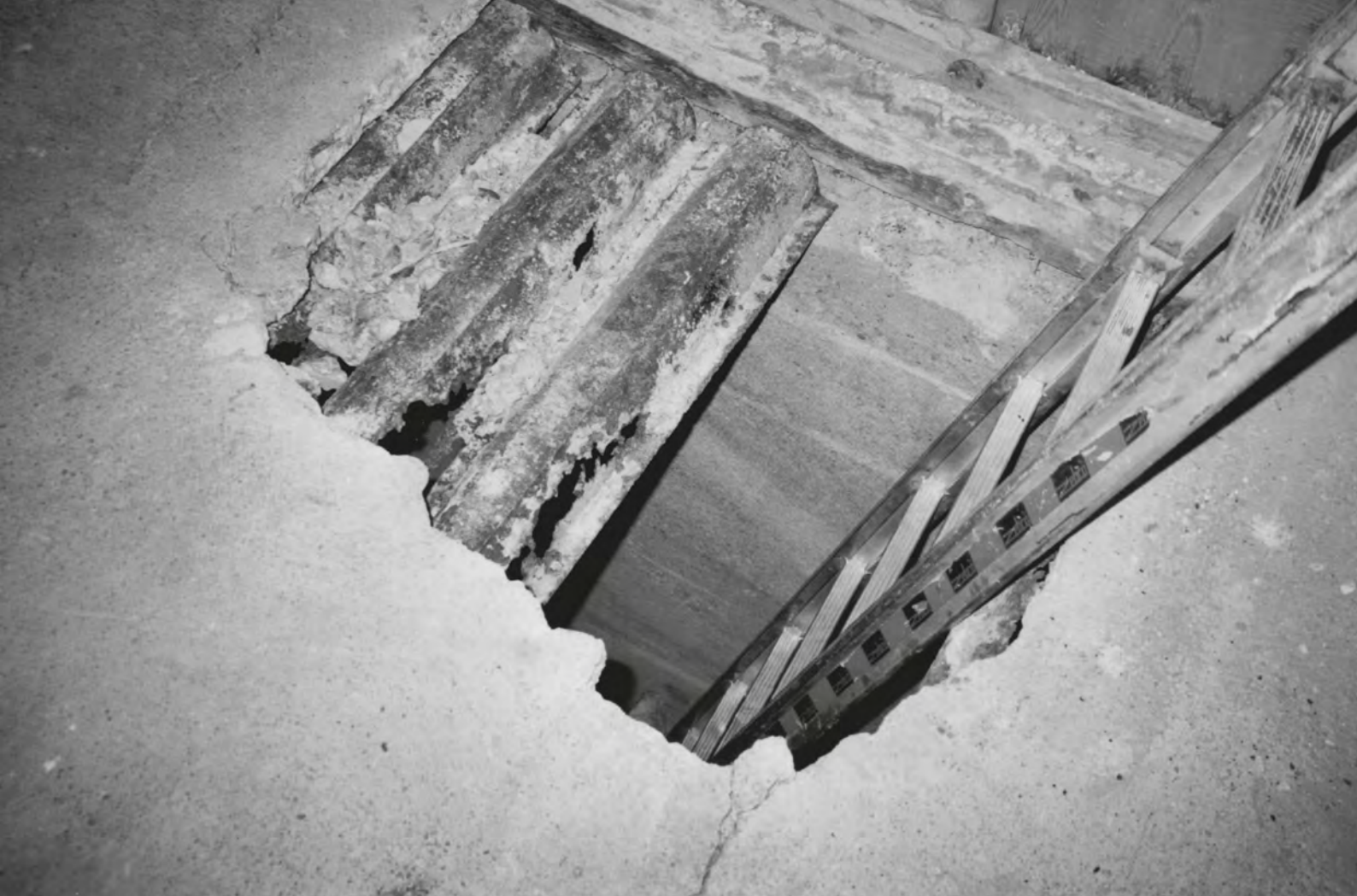
defekter Boden Zwischentrakt
